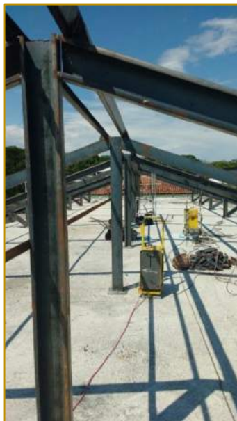
Figura 9. Estrutura metálica da cobertura oxidada.
