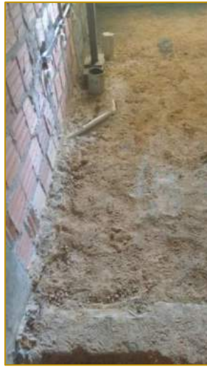
Figura 6. Rebaixamento no nível do solo no banheiro e viga baldrame.
