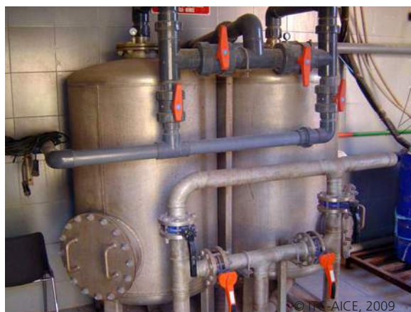
Figura 31. Filtros de arena.
