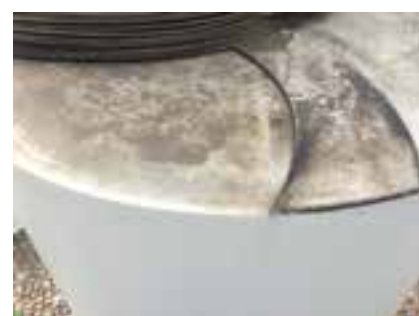
178-179 Notar a pintura realizada no cilindro metálico, apenas nas superfícies verticais. As superfícies horizontais, não receberam pintura e tampouco foram limpas.
