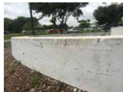
186-187 Notar a pintura dos módulos de concreto, que desconsidera as patologias existentes e qualquer cuidado com o recobrimento das superfícies. Notar que, apesar de recente, já apresentam sujidade generalizada. Comparar com as figuras 182-183.
