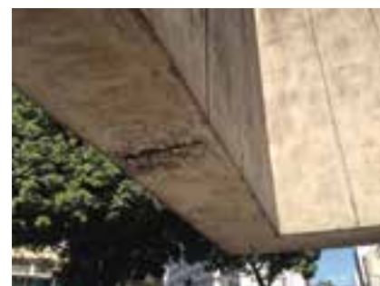
2012-2013 Notar o estado da obra antes da pintura, sendo visível a exposição das ferragens.
