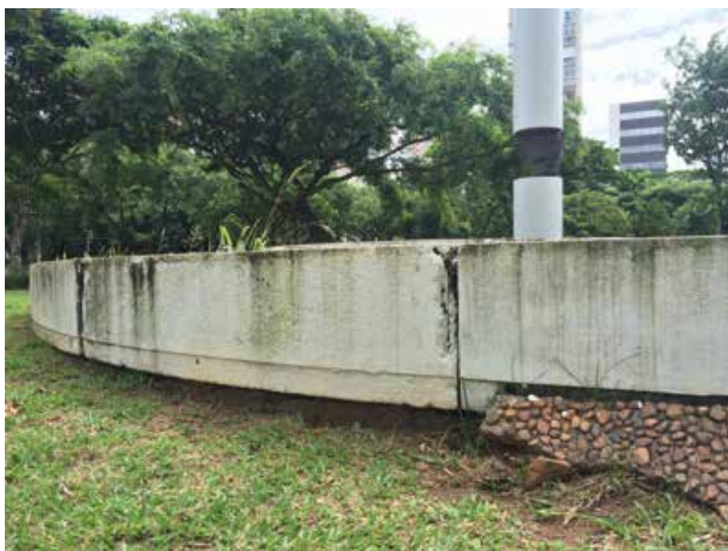
184-185 Notar a pintura dos módulos de concreto, que desconsidera as patologias existentes e qualquer cuidado com o recobrimento das superfícies. Notar que, apesar de recente, já apresentam sujidade generalizada. Comparar com as figuras 180-181.
