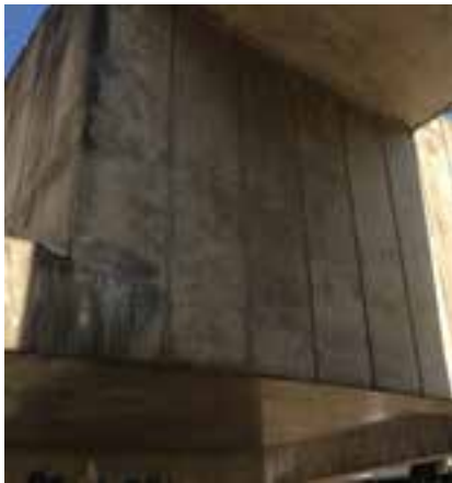
209-211 Notar o estado da obra antes da pintura, em que são visíveis os complementamentos das partes erodidas do concreto, pixações, ferragens expostas, fissuras e trincas.
