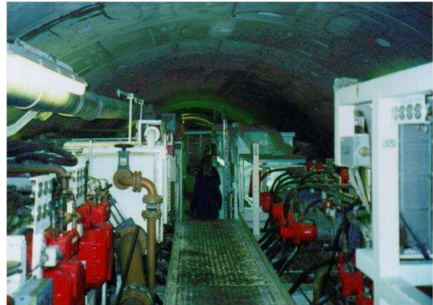
Partie arrière du tunnelier
