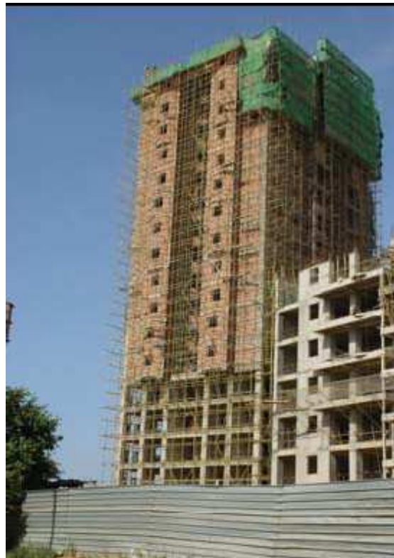
Fig. 4 Bâtiment avec voiles en béton armé, très bonne résistance à l'action sismique
