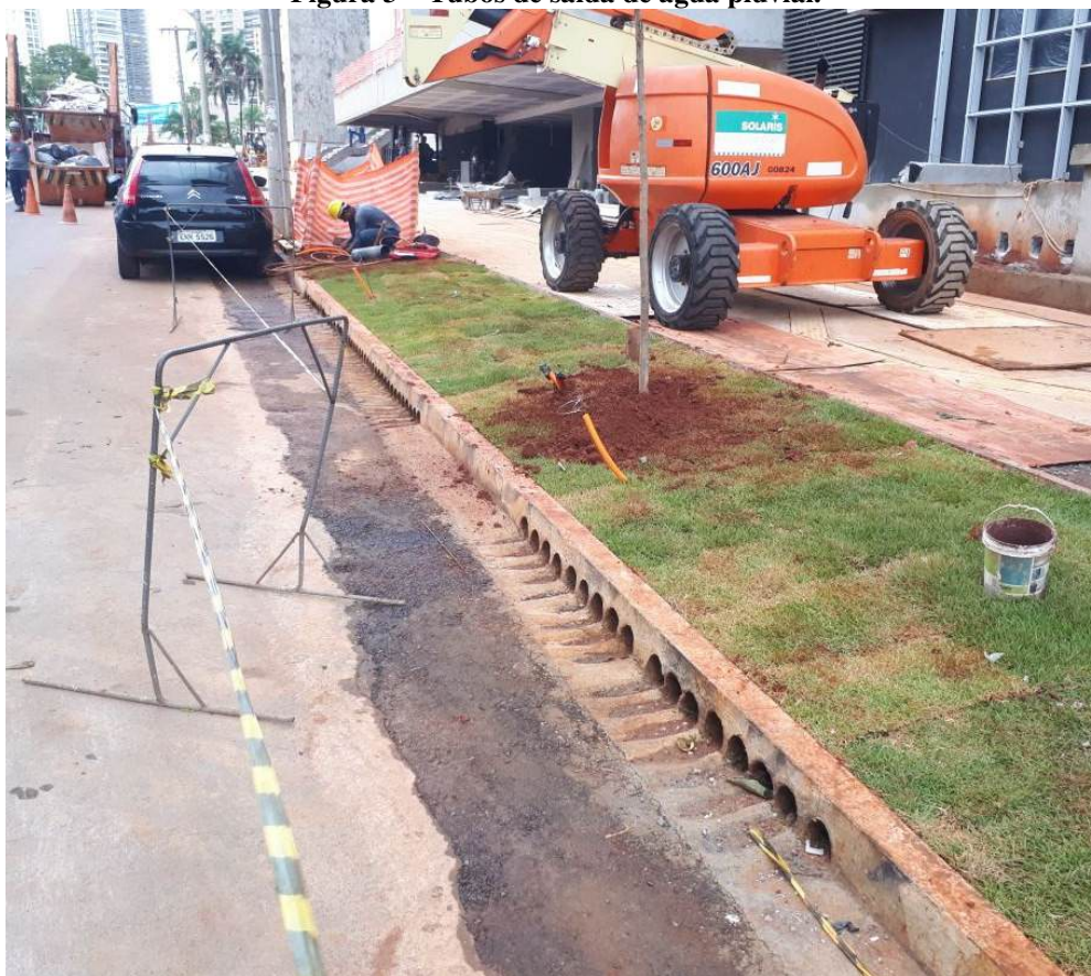
Figura 3 – Tubos de saída de água pluvial.
