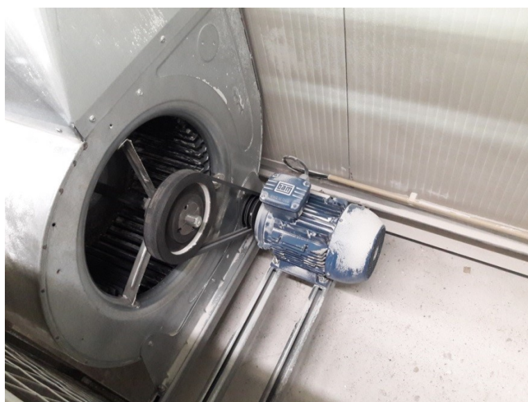
Figura 31 – Ventilador da cortina de pintura a seco
