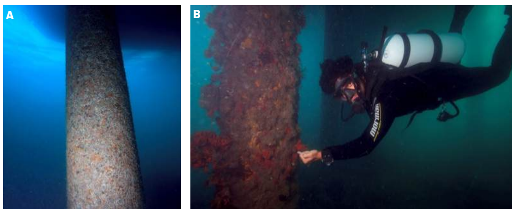
Figura 7. A. Pilar de concreto cilíndrico encontrado na Marina dos Pescadores no cais da Pesca na área portuária em Arraial do Cabo, RJ; B. Mergulhador realizando amostragem subaquática nos pilares. Fotos: Áthila Bertocini.
