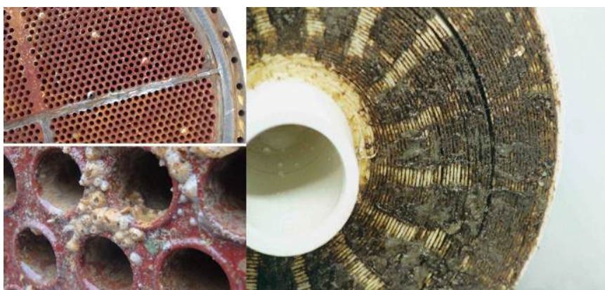
Figura 4. Crescimento biológico em trocadores de calor (à esquerda, foto: http://www.heatexchangeraia.co/tubular-heat-exchanger/thumb/tubular-heat-exchanger-in-india.jpg ) e membranas de osmose reversa (à direita, http://heatxcoatings.com/fouling-shield/ ).
