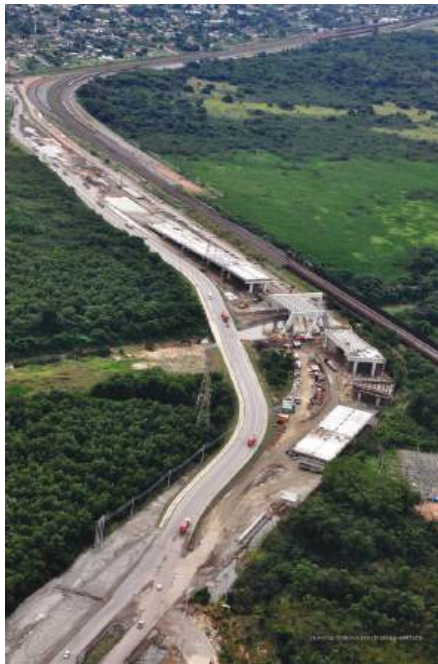
Figura 86: Complexo do Itaguaí no estado do Rio de Janeiro, composto por uma ponte ferroviária, uma ponte e dois viadutos rodoviários, todos em estrutura pré-fabricada de concreto
