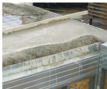
Figura 52: Laje Úmida (Fonte: CBCA)
