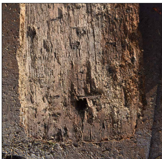
Afbeelding 51. Een gat in de onderzijde van stijl 3.
