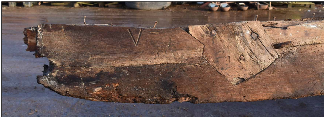
Afbeelding 45. Afgezaagde lipverbinding op de onderkant van de zuidelijke dekbalk (westzijde). Links daarvan een telmerk: V.
