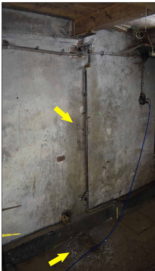
Afbeelding 29. De muur tussen de koeienstal en hooiberg. Bij de pijlen een afwijkende plek in de betonvloer en een bevestigingspunt op de muur.
