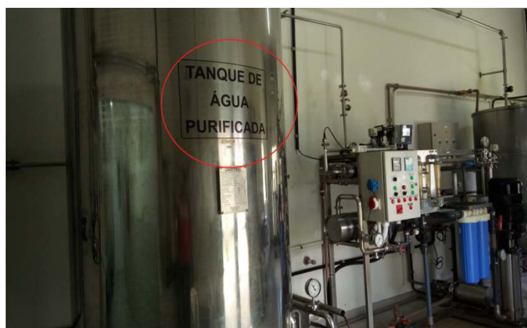
Figura 3. Tanque de Água Purificada. Fonte: autor (2017).
