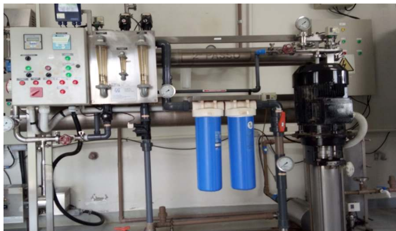
Figura 2. Sistema de Osmose Reversa. Fonte: autor (2017).
