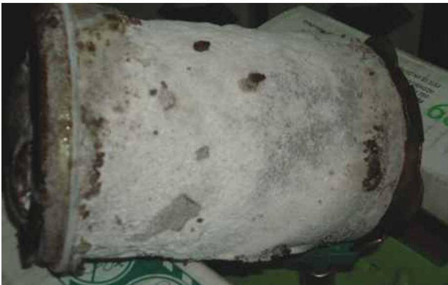
Fig. 7.2.- Piedra de filtro saturada de humedad y corrosión del sistema
