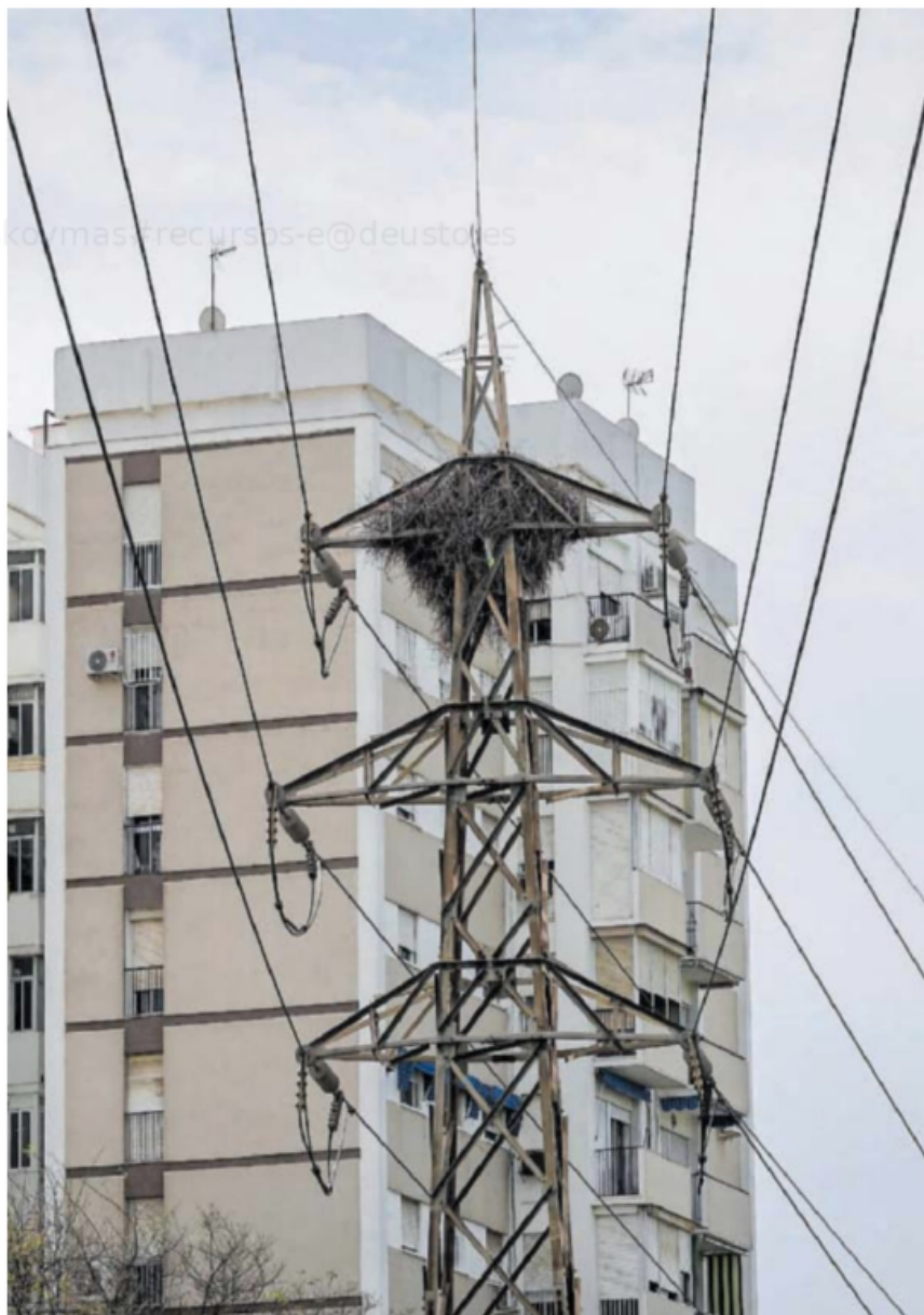
Tendido eléctrico en el barrio del polígono de San Pablo, en Sevilla. ALEJANDRO RUESGA
