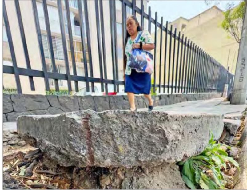
▲ Aceras desniveladas, bloques de cemento descuadrados, levantados, fisurados, en terracería y con huecos es el escenario urbano que enfrentan
