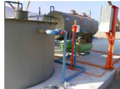
Figura 1.6.1 Planta piloto de biogás
