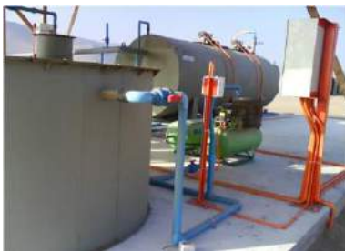
Figura 1.6.6 Planta piloto de Biogás
