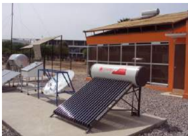
Figura 1.6.4 Energía solar térmica
