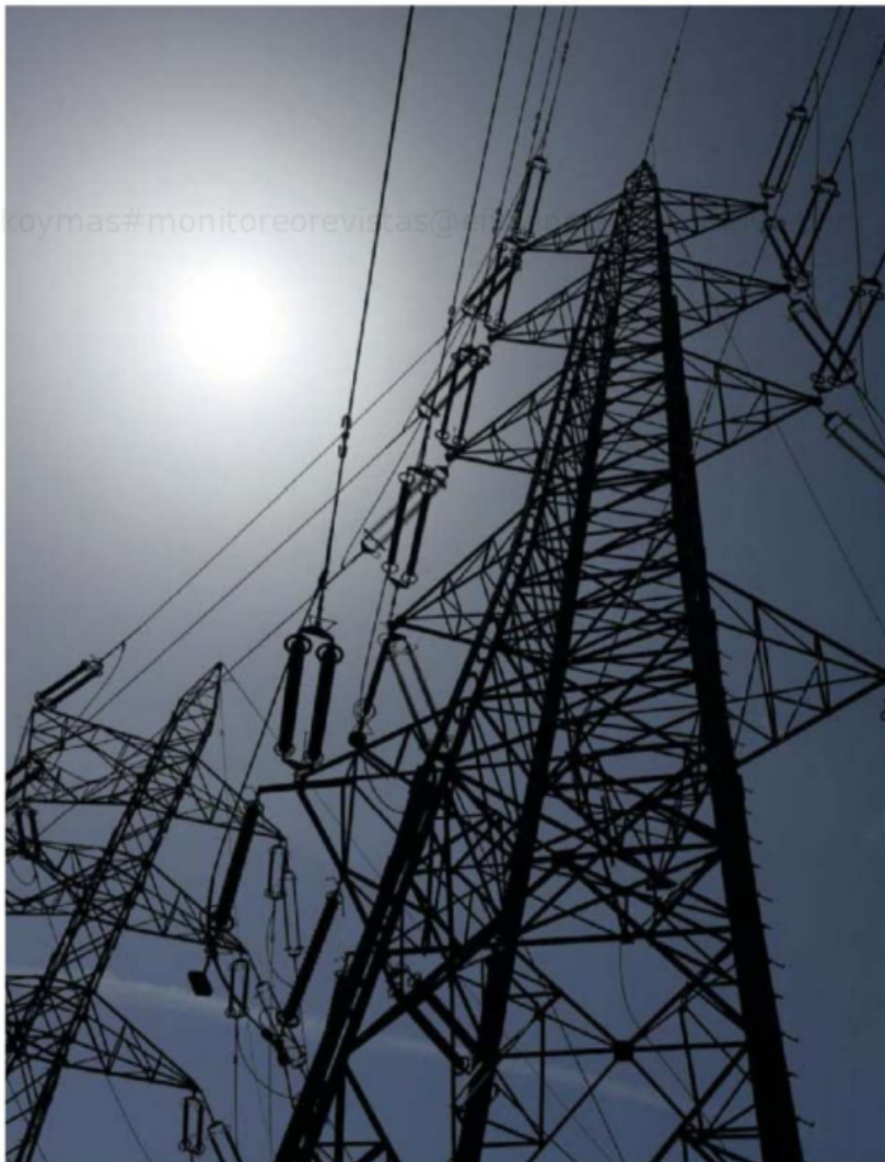
Torretas de la subestación eléctrica Los Ramos, en Málaga. JORGE ZAPATA (EFE)
