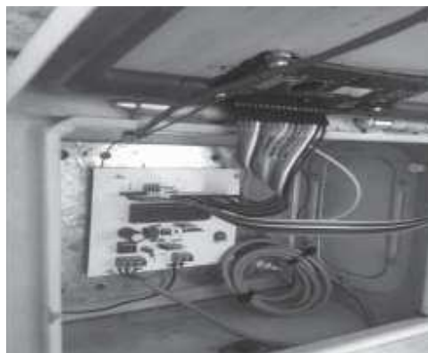
Figura 4. Vista Interior del Circuito Instalado
