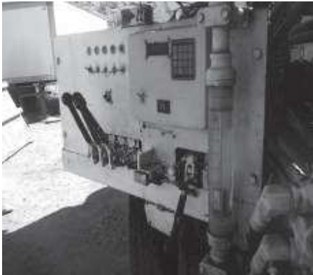
Figura 4. Vista Exterior del Circuito Instalado
