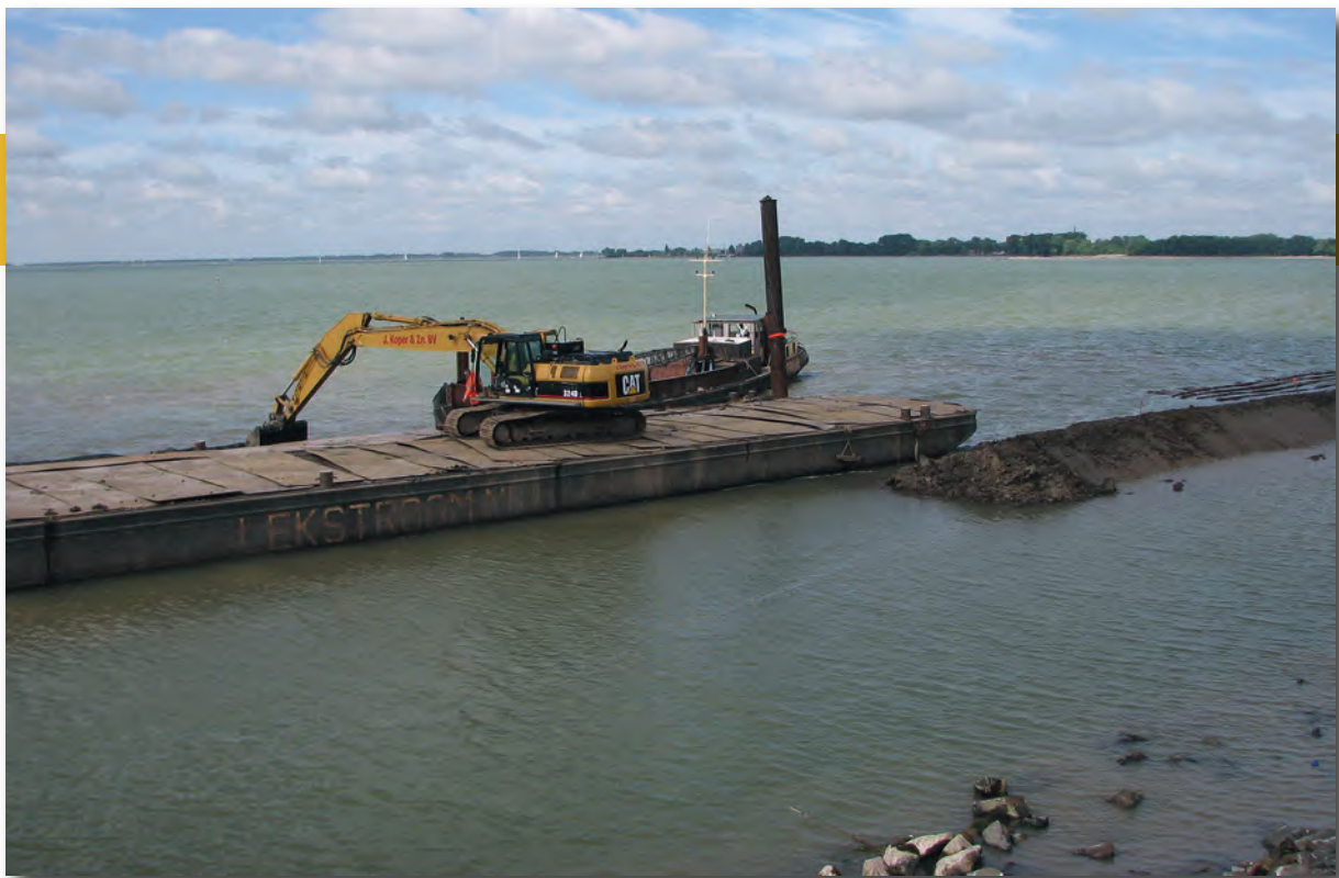
23.79 In het water van het Hoornse Hop wordt met klei een voordijk gebouwd in de zomer van 2008.
