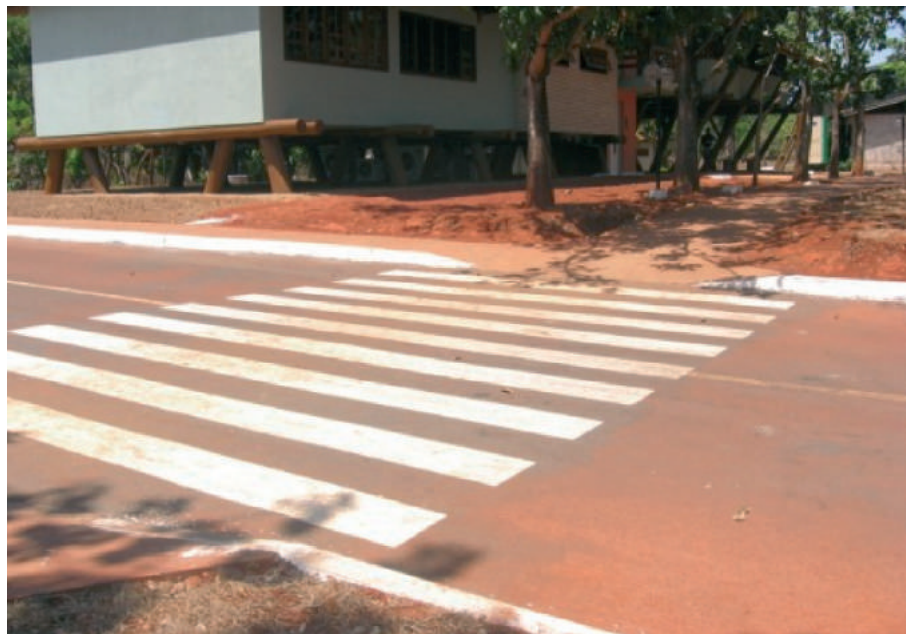
A instalação de faixas de pedestre e as guias rebaixadas são importantes elementos de inclusão dos portadores de necessidades especiais.
