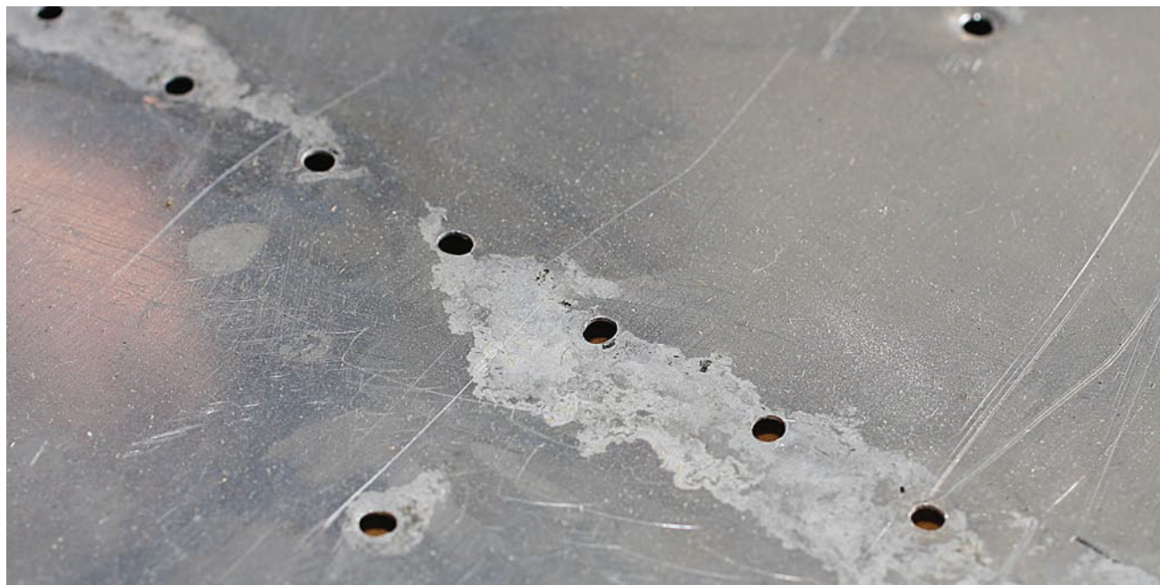
Figura 6-5. Corrosão de superfície.
