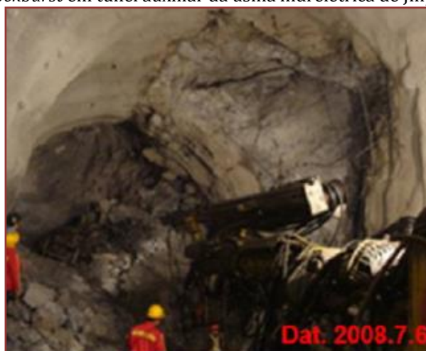
Figura 2. Rockburst em túnel auxiliar da usina hidrelétrica de Jinping, China.
