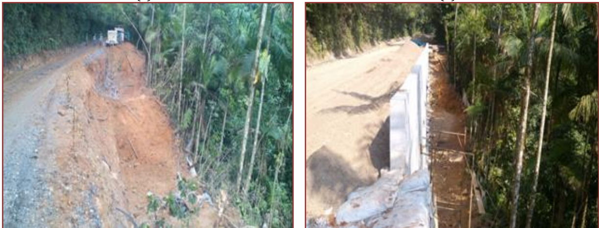
Figura 2. (a) Vista geral do escorregamento, (b) Vista geral recuperação de encosta com cortina atirantada.
