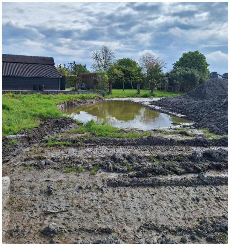
Afbeelding 30. De situatie aan de Zwaagdijk naast 375A. De plas water is de locatie van de bodemsanering.
