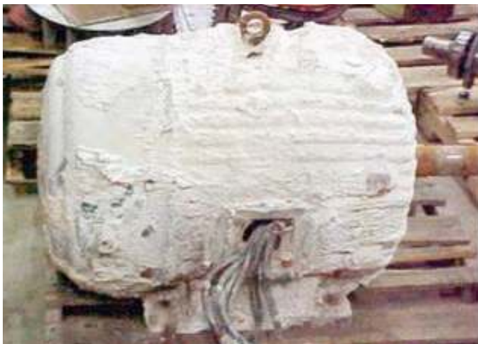
Figura 15. Motor con aletas de enfriamiento obstruidas.
