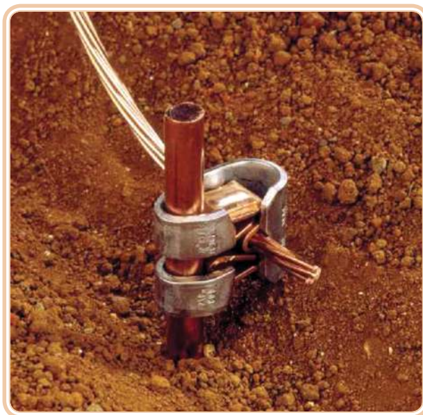
Figura 5.16: Haste de aterramento e fio terra conectado
