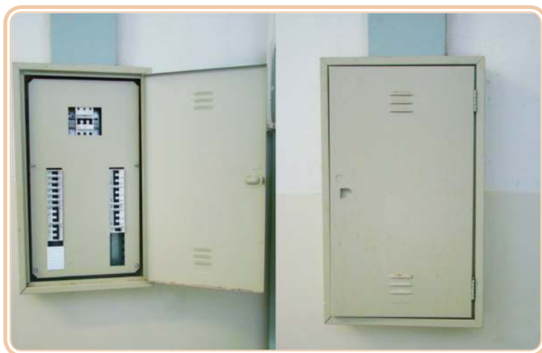
Figura 4.7: Quadro de distribuição com seus disjuntores
