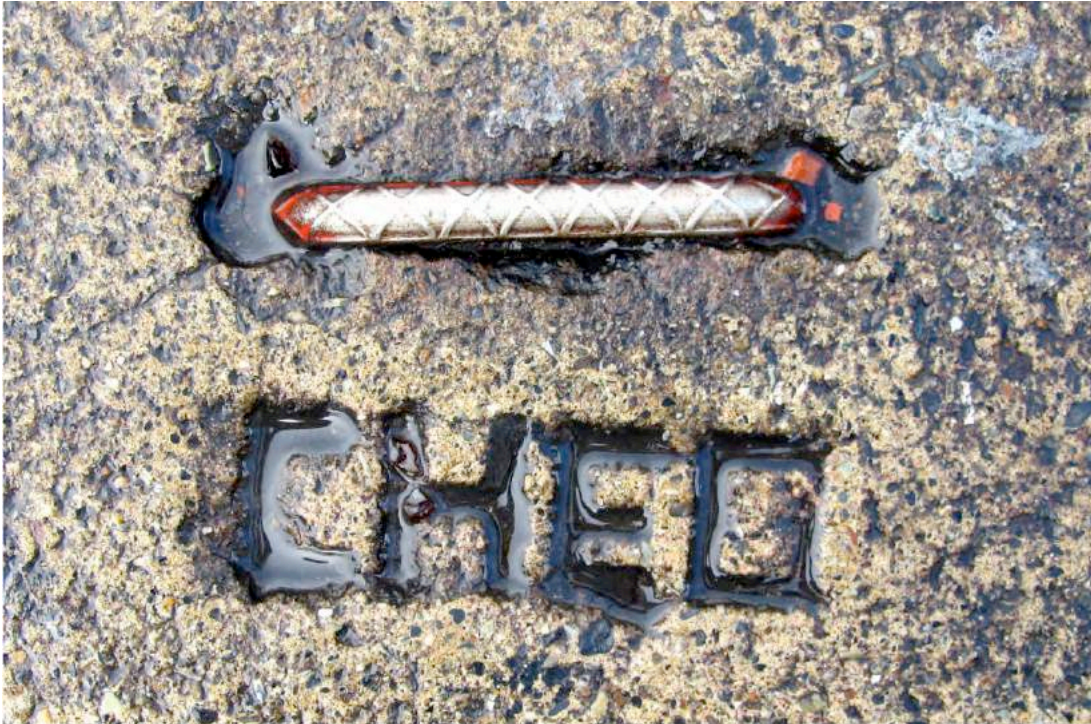
Figura 4. Tapa de bueiro em Manizales (Colômbia), 2015.
