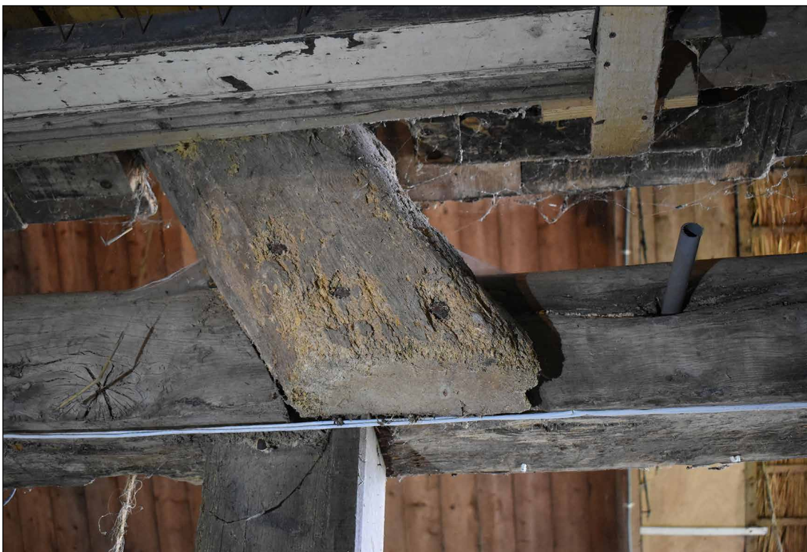
Afbeelding 53. Onderzijde van een zwing aan de westzijde. De onderkant van de zwing is afgezaagd, de kop is bevestigd aan de draagbalk.
