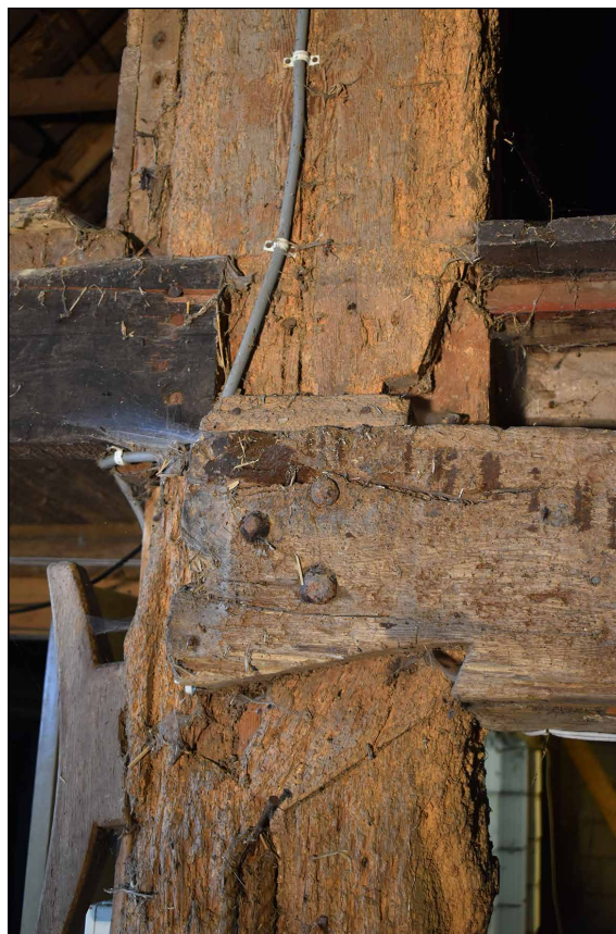
Afbeelding 51. Afgezaagde zwing op de noordwestelijke stijl. Het was bevestigd door middel van een lipverbinding met hak. Daarop de lipverbinding van de westelijke draagbalk.
