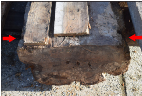
Afbeelding 74. Twee vlotgaten in de onderkant van de zuidwestelijke stijl.
