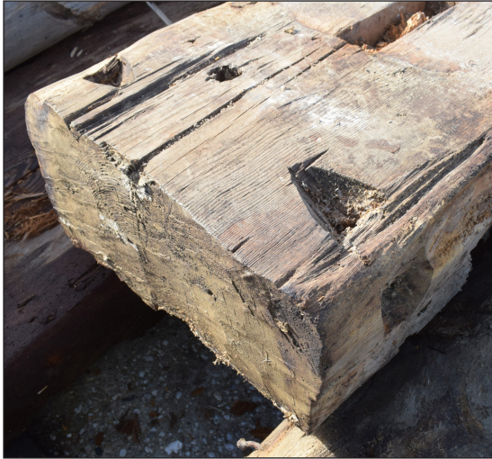
Afbeelding 72. Twee vlotgaten in de oostelijke dekbalk.
