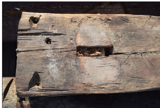
Afbeelding 46. Pengat in de onderzijde van de oostelijke dekbalk.
