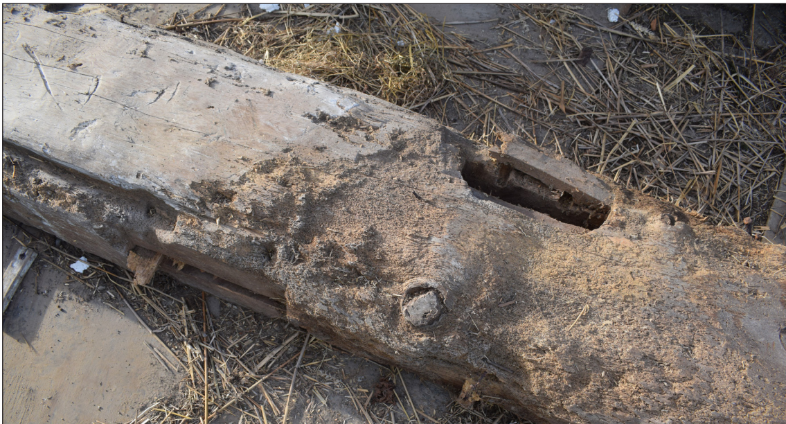
Afbeelding 53. Twee pengaten van draagbalken aan twee zijden van de noordwestelijke stijl. Zij bevinden zich niet op dezelfde hoogte.
