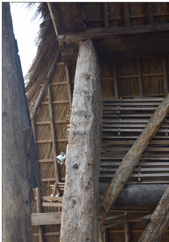
Afbeelding 37. De noordoostelijke stijl. In het hout zijn veel knoesten zichtbaar.
