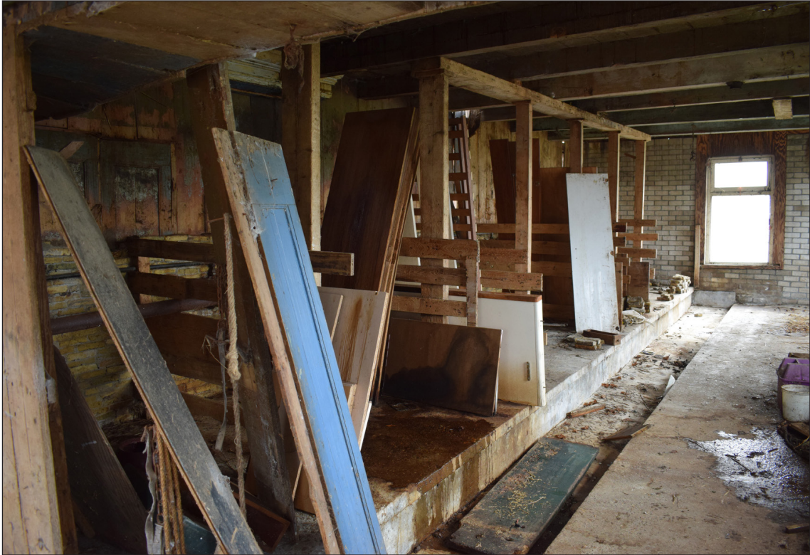
Afbeelding 22. De stal aan de voorkant van de boerderij, op de plek van de oude woonvertrekken.
