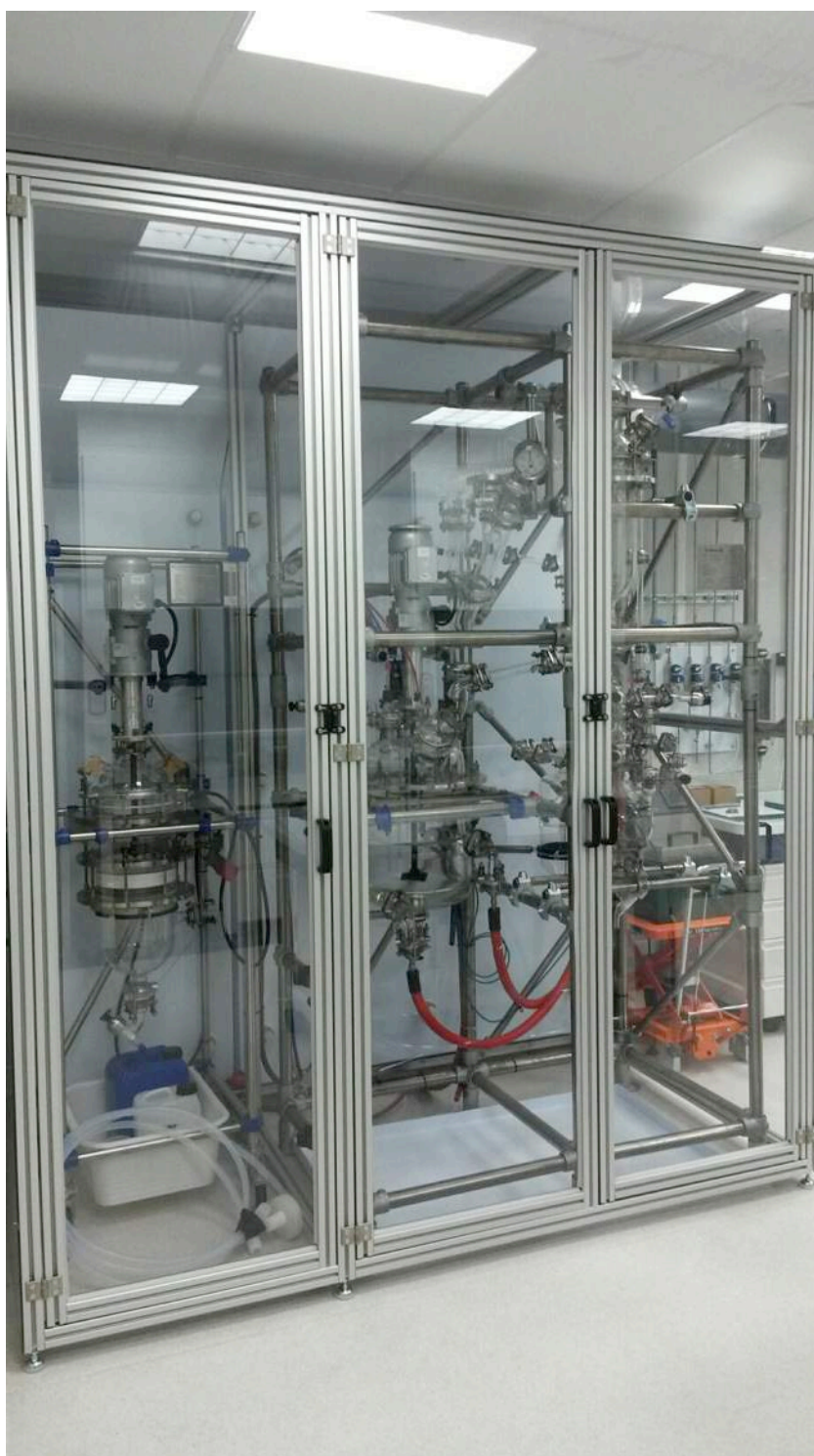
Au CEA Liten : Réacteur de synthèse de matériau organique pour électrodes de batteries qui permettra de produire plusieurs centaines de grammes à chaque lot (contre seulement quelques grammes actuellement). © CEA
