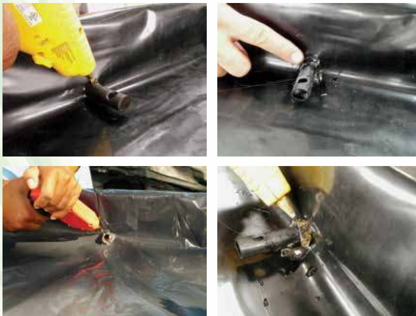
Foto 12. Sellado del drenaje en el punto de contacto entre el plástico y la manguera.
