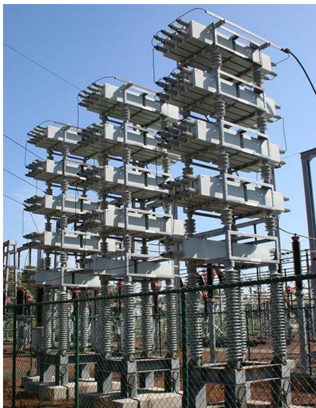
FIGURA 15.14 Los condensadores de potencia se utilizan para equilibrar la impedancia de la inductancia efectiva en las líneas de transmisión.
