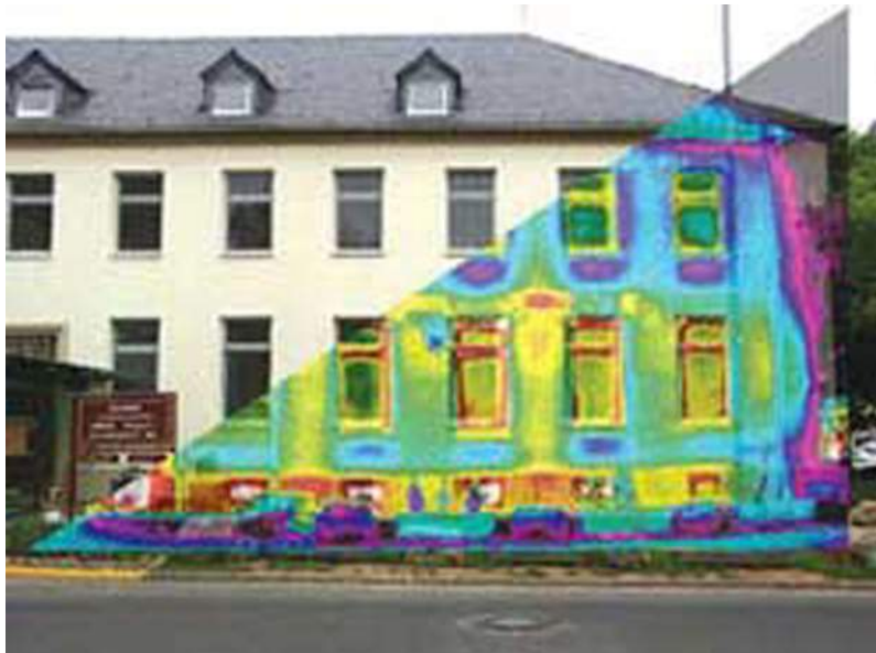
FIGURA 1.32 Una termografía de parte de un edificio muestra las variaciones de temperatura, e indica dónde es más intensa la transferencia de calor al exterior. Las ventanas son una de las principales regiones de transferencia de calor al exterior de las viviendas (créditos: Ejército de los EE. UU.).
