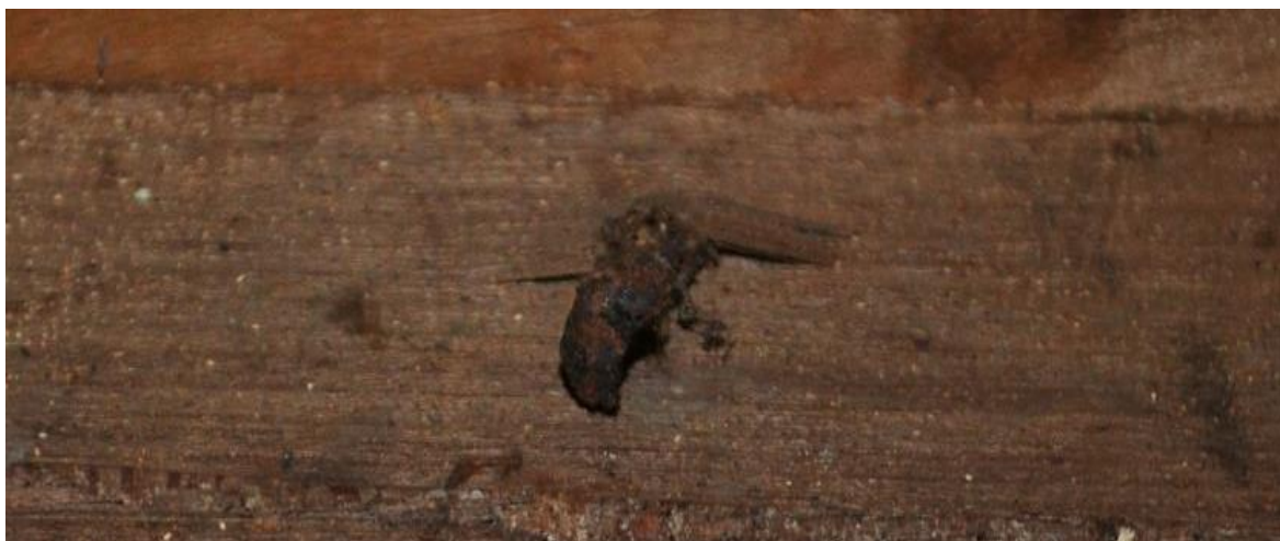
Fig. 20 – Prego oxidado na face interior da ilharga lateral esquerda da mesa A. Fonte: de Elaboração própria
