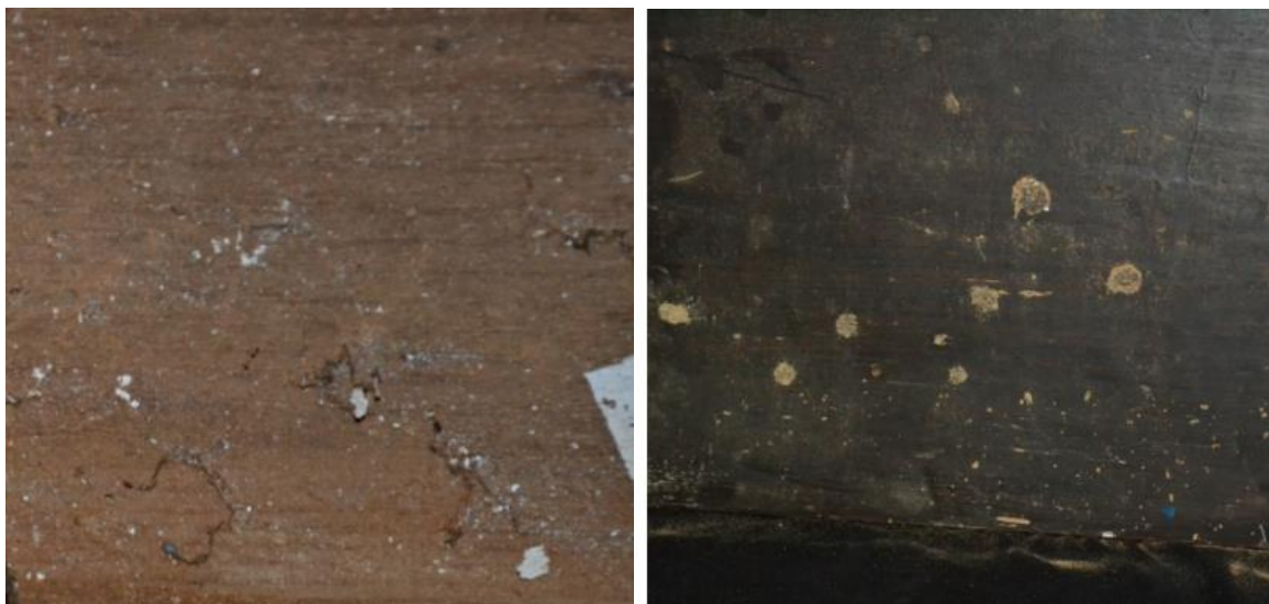
Fig. 13 – Registo de pormenor do tampo da mesa B onde se observa a deposição de sujidades: tampo da mesa B, face interior com sujidades desagregáveis e face superficial com sujidades agregadas e superficiais. Fonte: de elaboração própria.
