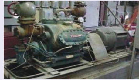
Fig 35. Compresor abierto para compresión de amoniaco
