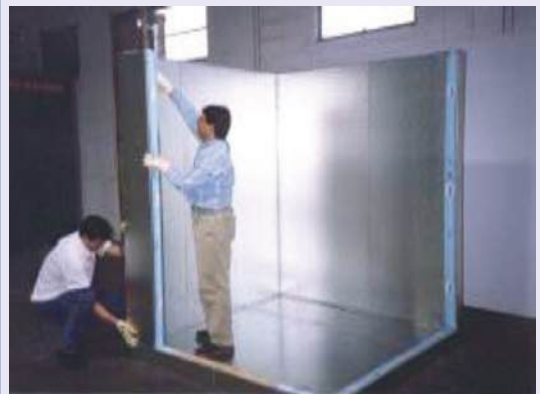
Fig 20. Aislamiento en los cuartos fríos
