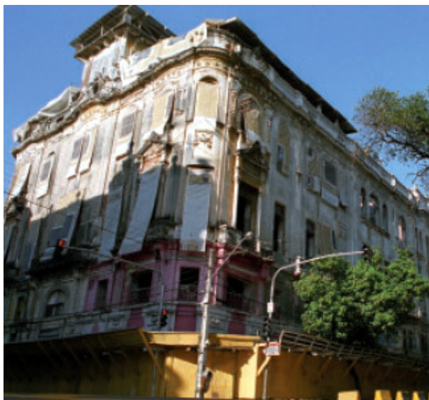
Fig. 46 – Recife, edifício Chanteclair. Desapropriado e desocupado para receber as obras de reabilitação e tornar-se centro de entretenimento. Fonte: www.monumenta.gov.br .
