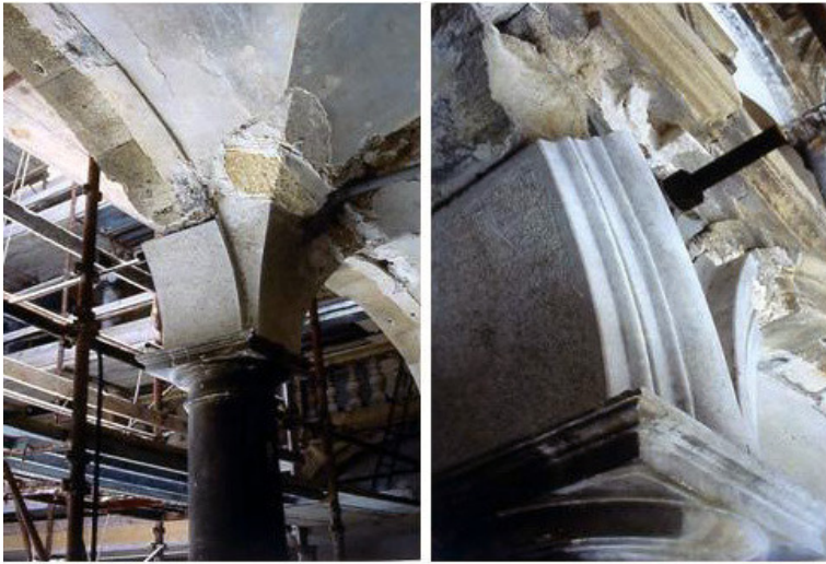
Fig. 32/33 – Palazzo Riccio di San Gioacchino, Trapani, restauro de repriminação, arq. Paolo Marconi, 1997. Fonte: www.paolomarconiarchitetto.it
