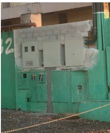
Figura 2 – Entrada de Energia
