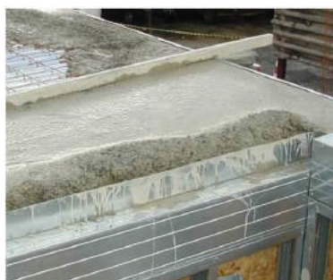
Figura 52: Laje Úmida (Fonte: CBCA)
