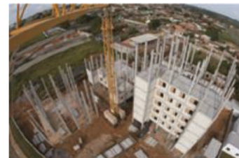
Figura 4: Sistema construtivo em pré-fabricados em concreto aplicados no segmento habitacional (Font: ABCIC)
