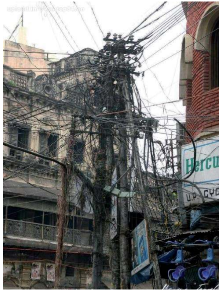
Figura 7.10: Conexões de fios em um poste
