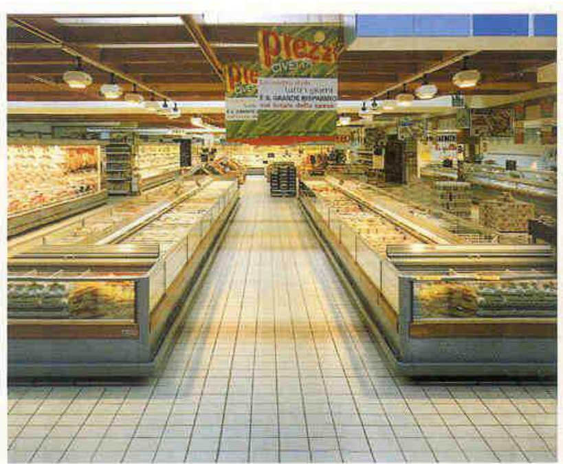
FIGURA 5 - REFRIGERAÇÃO COMERCIAL EM SUPERMERCADOS
