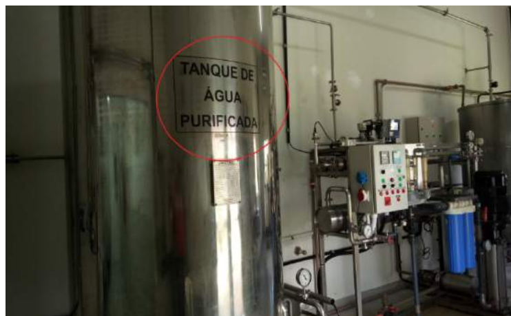
Figura 3. Tanque de Água Purificada. Fonte: autor (2017).
