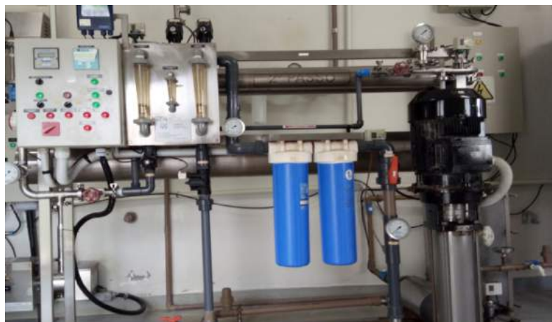
Figura 2. Sistema de Osmose Reversa. Fonte: autor (2017).
