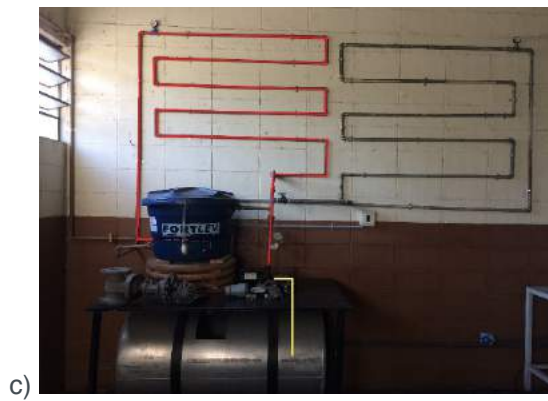
(Figura 7- Bancada Hidráulica 1 “caso c”)
