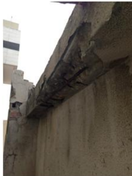
Figura 53- Corrosão das armaduras dos bordos das lajes dos anexos
