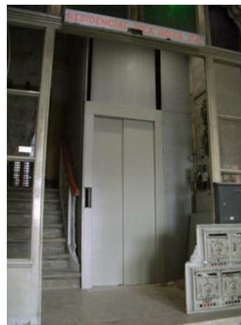
Figura 46- Porta de patamar do elevador (Costa, 2010)
