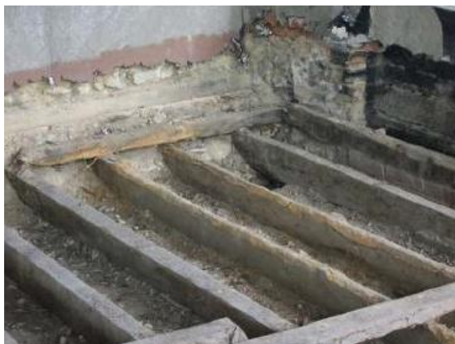
Figura 17- Apodrecimento das vigas de madeira do pavimento de esteira (Costa, 2010)
