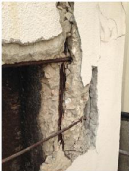
Figura 52- Corrosão das armaduras na chaminé
