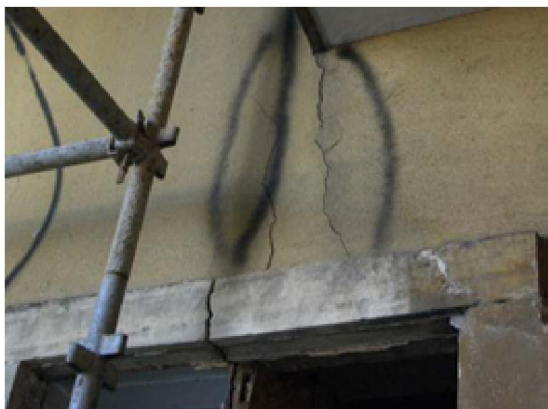
Figura 23- Identificação da fissura direcionada (Costa, 2010)
