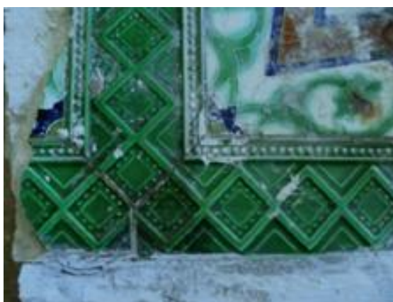
Figura 34- Azulejo existente (Costa, 2010)
