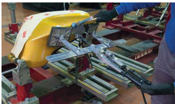
Estiraje del daño mediante el puente.
