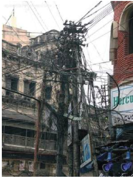
Figura 7.10: Conexões de fios em um poste
