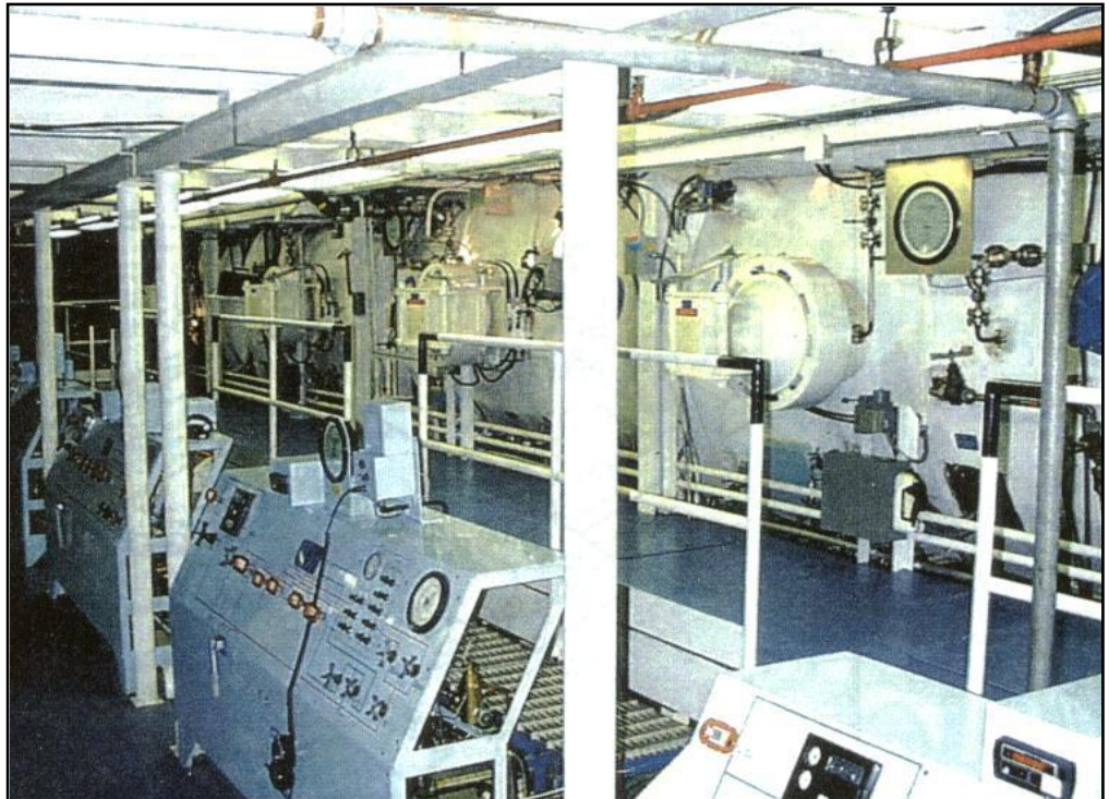
FIGURA 15-5. Complejo de Cámaras de Buceo de Saturación en las Instalaciones de Simulación Oceánica (OSF) de la NEDU.
