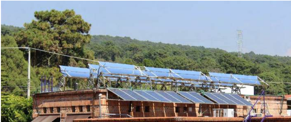
Figura 14. Vista panorámica de sistema fotovoltaico y concentradores cilíndrico parabólicos.
