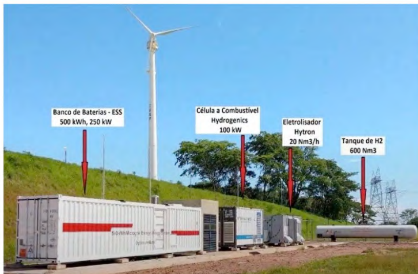
Figura 1 – Sistema de Armazenamento de Energia Elétrica na forma de hidrogênio instalado na UHE de Porto Primavera (6)
