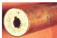
Fig. 2.42 Tubería obstruida por sarro.
