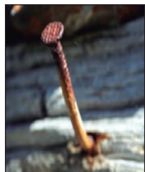
Fig. 1.39 Corrosión del hierro.
