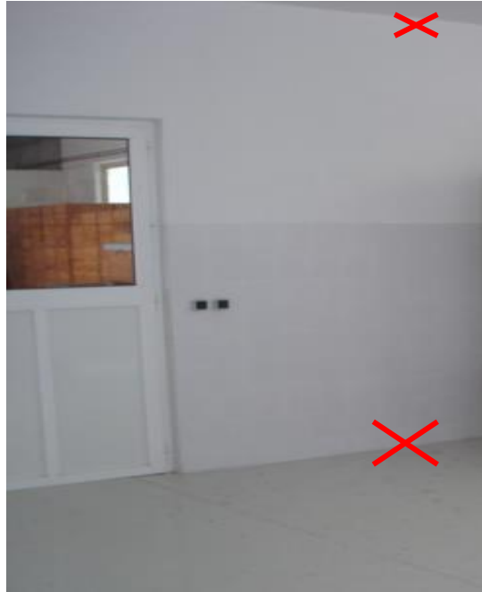
Figura 215. Aspetos estruturais da unidade da produção primária de mel: as esquinas, ângulos e uniões entre paredes, entre paredes e pavimento e entre paredes e teto devem ser arredondados (X assinala a ausência de perfil sanitário).
