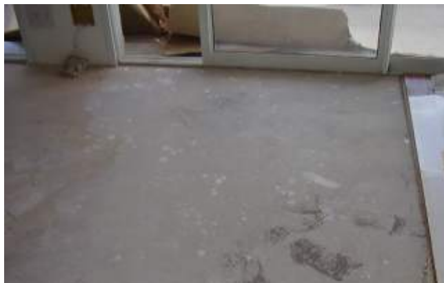
Figura 30. Contrapiso sem impermeabilizante.
