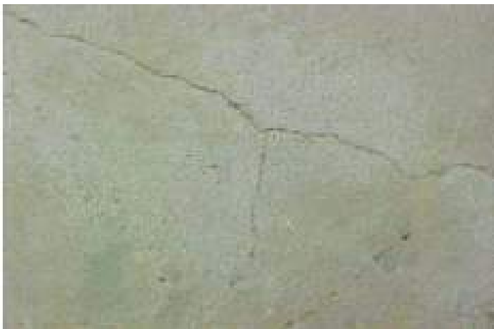
Figura 17. Trincas de cura no contrapiso.
