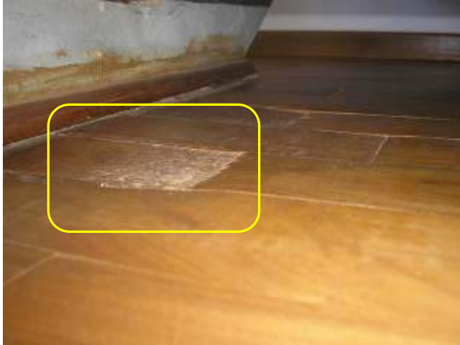
Figura 65. Lixamento imperfeito, piso mal acabado.
