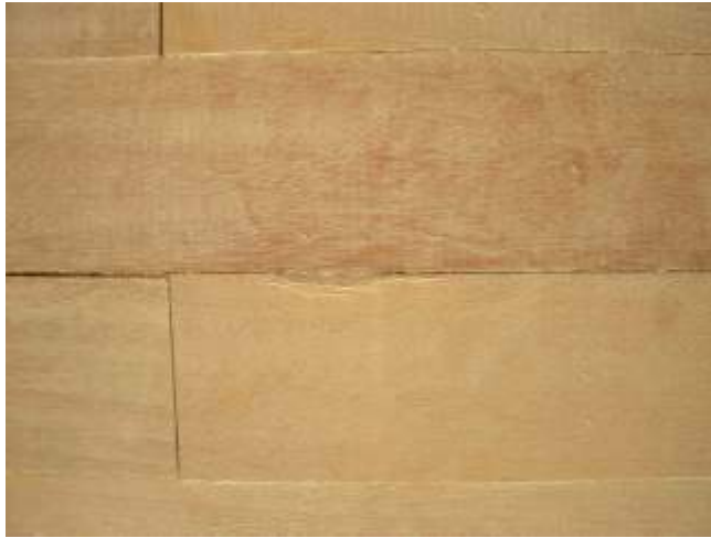
Figura 57. Falta de madeira na quina da peça.
