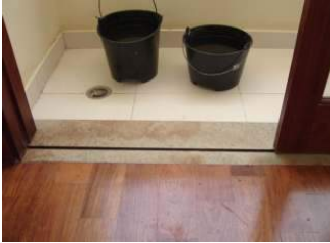
Figura 69. Situação de risco durante limpeza de pisos frios.
