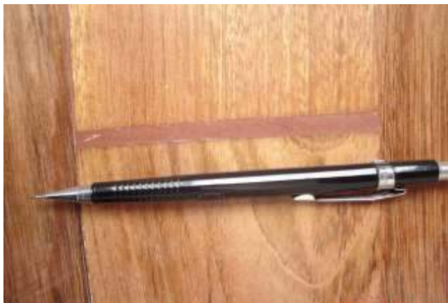
Figura 67. Topos afastados e com excesso de massa de calafetação.
