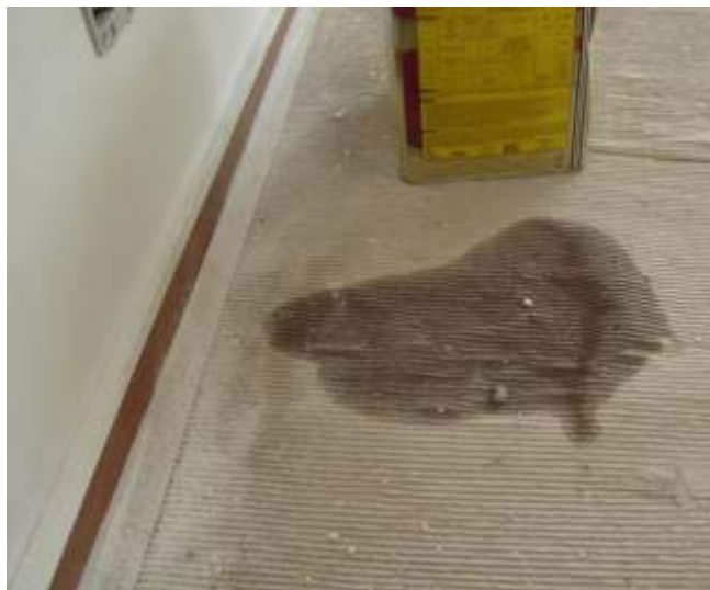
Figura 70. Proteção insuficiente do piso durante a reforma do imóvel.
