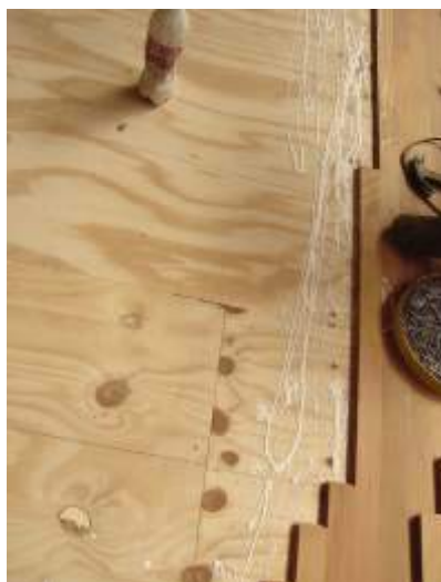
Figura 33. Aplicação incorreta de adesivo.
