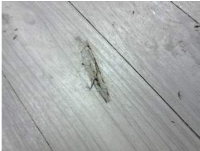
Figura 58. Falta de madeira na superfície da peça.
