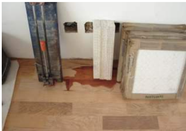
Figura 71. Falta de proteção total do piso de madeira durante reforma do imóvel.
