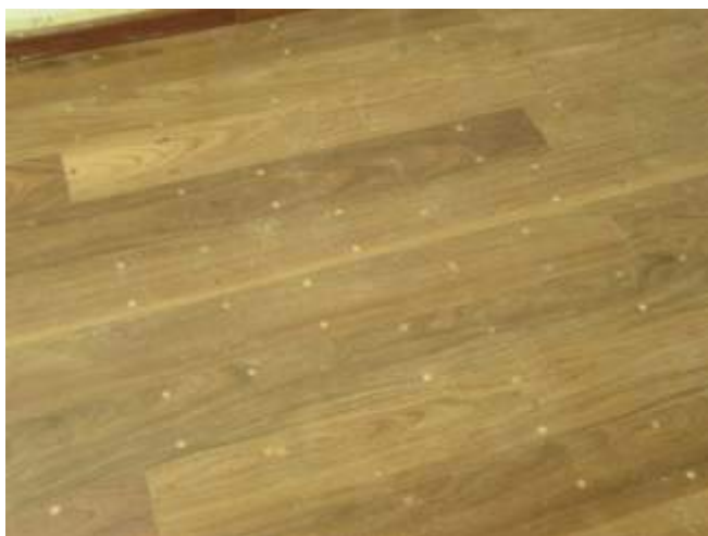
Figura 68. Cavilha de cor muito diferente do piso.
