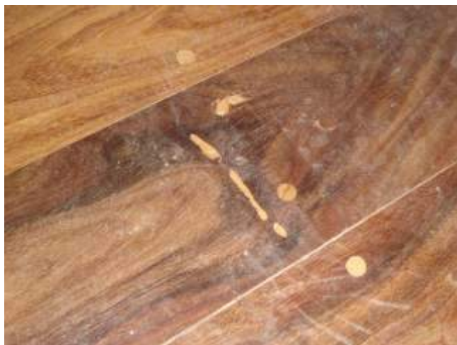
Figura 50. Furo de inseto coberto com massa de calafetação.
