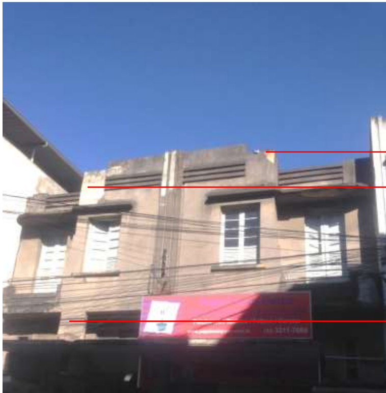
Figura 6: Patologias em Art Déco popular Rua Marechal nº101 Juiz de Fora.
