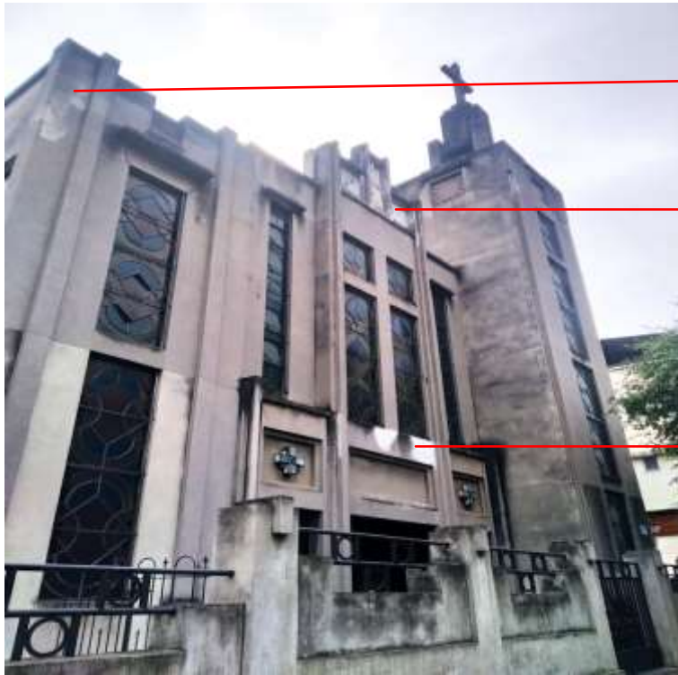
Figura 7: Patologias e descaracterização do revestimento na Capela de Santa Catarina Av dos Andradas, 1036.
