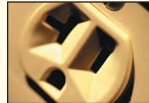
Las conexiones deben hacer tierra adecuadamente
