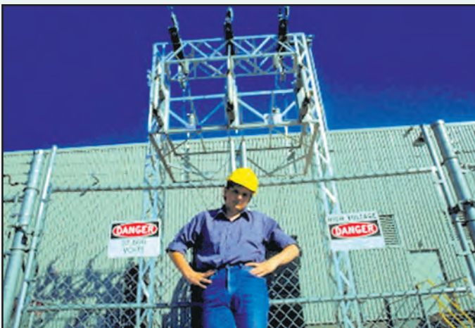
Este equipo eléctrico expuesto está resguardado por una valla de 8 pies.
