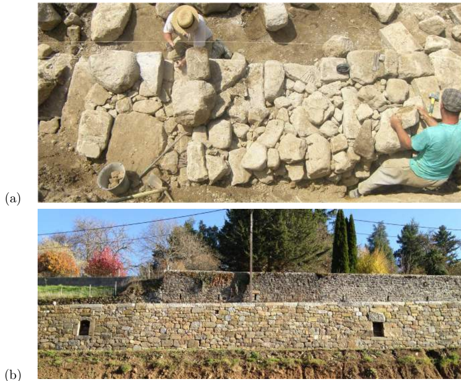
Figure 4.3 – Construction (a) et vue du mur de soutènement en pierre sèche de Felletin en Creuse (b).
