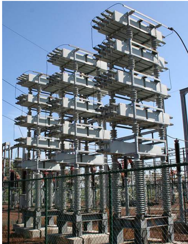
FIGURA 15.14 Los condensadores de potencia se utilizan para equilibrar la impedancia de la inductancia efectiva en las líneas de transmisión.
