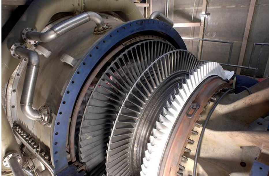
FIGURA 13.31 Turbina/generador de vapor. El vapor producido por la combustión del carbón impacta en las aspas de la turbina, haciendo girar el eje, que está conectado al generador.
