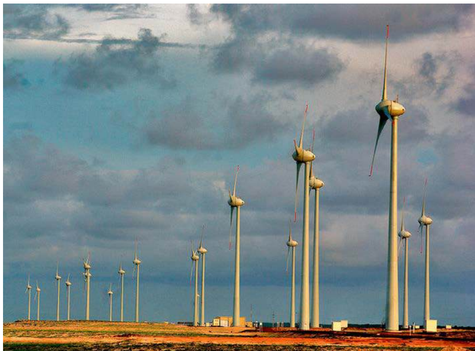
Fazenda eólica, com vários cata-ventos e geradores
